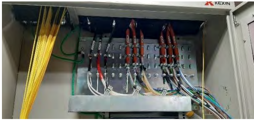
Mumbai (Kalyan) Fibre Cables
